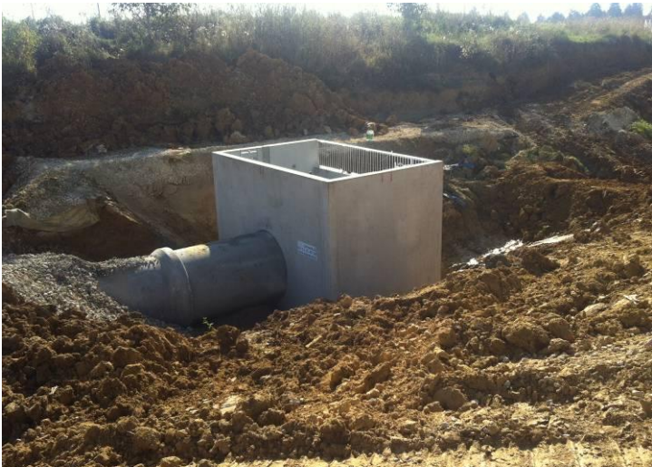
Un regard « régulateur de débit » déjà entièrement équipé pour nous simplifier la vie.
