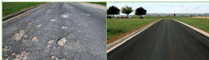
À gauche, l'ancienne chaussée très dégradée et, à droite, la nouvelle voie retraitée en place au LHR, recouverte d'enrobé coulé à froid.
